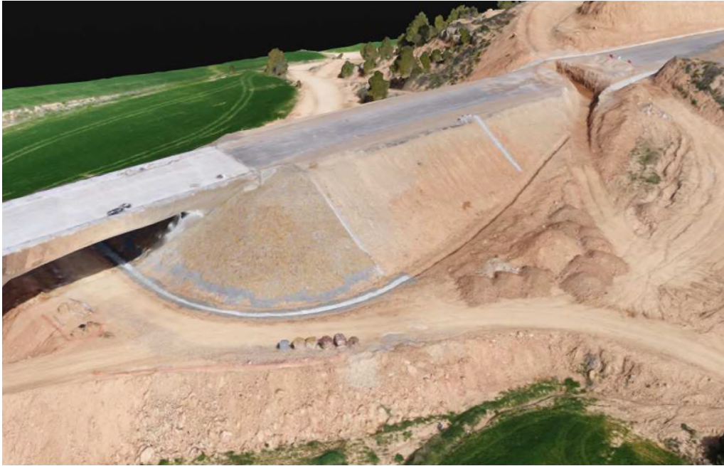
Foto 15.- Ejecución de zanja drenante transversal en la transición de un desmote hacia un terraplén de acceso a una estructura
