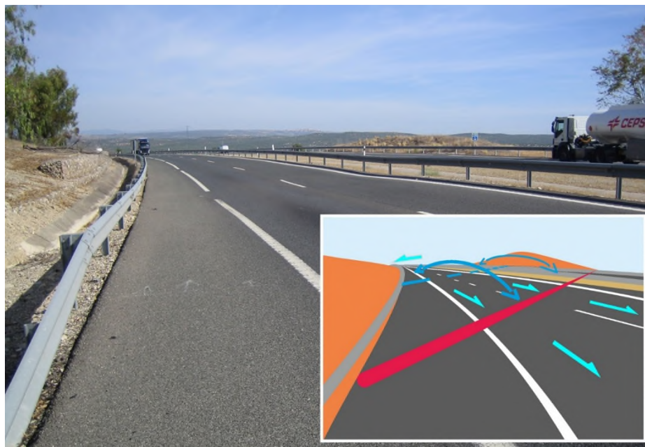
Foto 11.- Asiento en la transición desmonte-terraplén (véase la barrera metálica en la mediana) por existencia de acuerdo vertical cóncavo como se indica en el croquis. El talud en desmonte en la parte derecha de la imagen es bastante corto (no así el de la izquierda); no obstante, ello es suficiente para materializar una transición a sección completa con una importante componente longitudinal.
