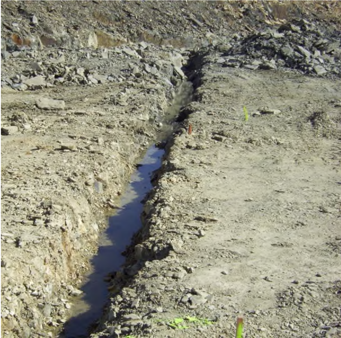
Foto 31.- Detalle de afloramiento de agua en una de las zanjas de la Foto 30
