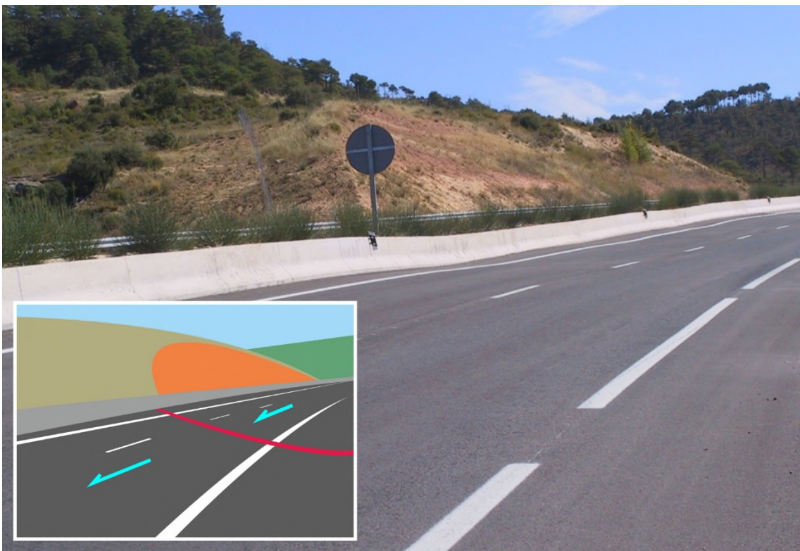
Foto 14.- En un caso bastante similar al de la Foto 13, los materiales del desmonte y del núcleo del terraplén son arcillas margosas con CBR bajo, lo que acrecienta el fenómeno objeto de esta nota
