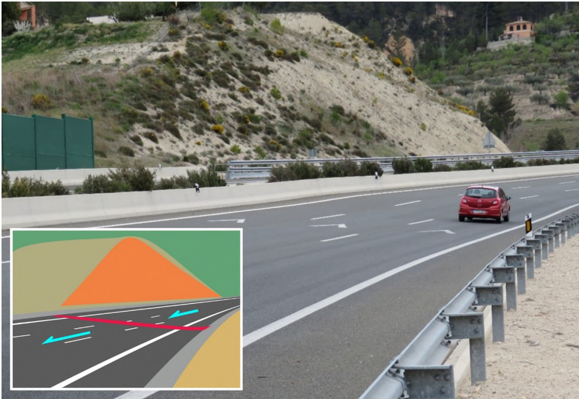
Foto 13.- Al caso general objeto de esta nota se unen materiales margosos tanto en fondo de desmonte como en el núcleo del terraplén, lo que acentúa más la problemática de la transición, que se traduce en la formación de una onda larga perceptible en la barrera rígida de mediana
