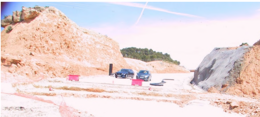
Foto 17.- Vista del desmote que antecede al terraplén y de la parte superior de la zanja durante su ejecución, en imagen tomada desde el terraplén que la sucede
